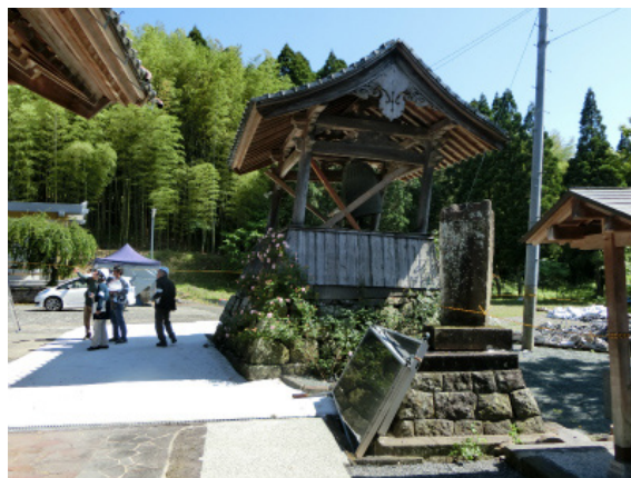
かなり傾いている皆垂寺の鐘楼、支える石垣もかなり崩壊していた
