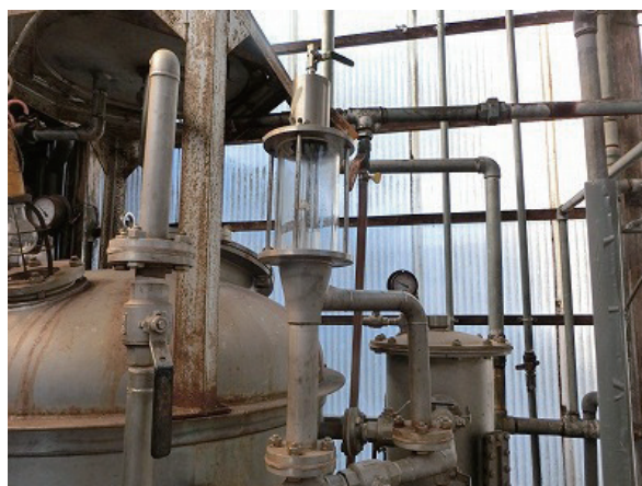
中の圧力をみる装置（ガラスのケース）
